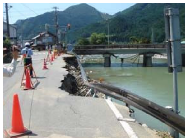
図 1.5 橋梁上流側の護岸被害
