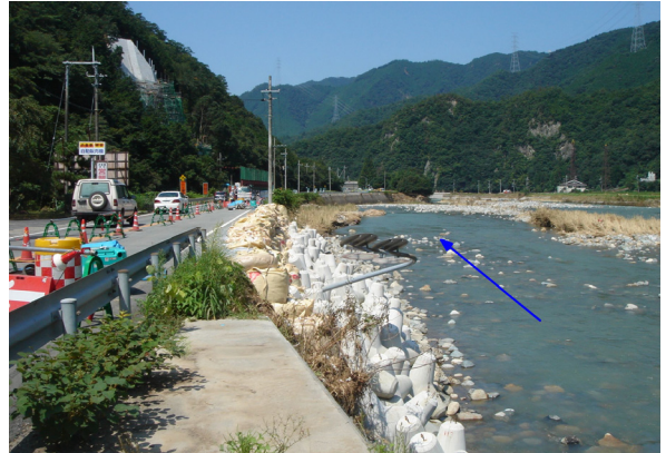
図 1.3 兼用護岸の被災状況
